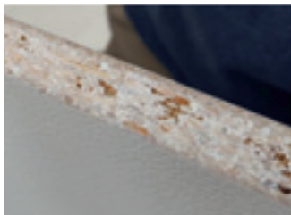
Figura 71. Esempio di strato funzionale delaminato.
